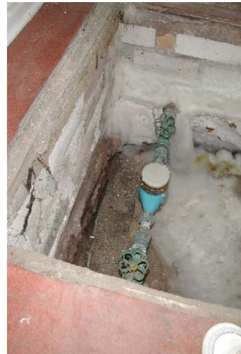
Schimmel im Schacht 01.03.2011
